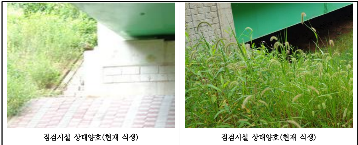
【사진 25.3.24】 교량 점검시설 손상현황
